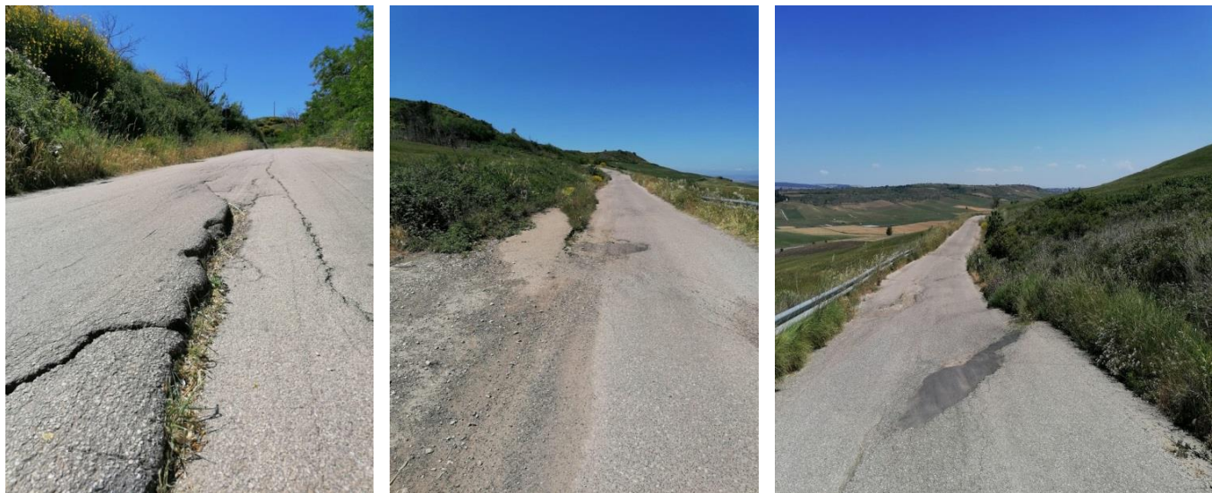
Foto n. 6 – Nelle foto si può notare lo stato di pericolosità della strada di bonifica “damarosa” in loc. Zingariello.
